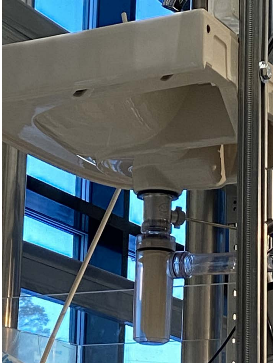
Detaljer som till exempel vattenlås och hur de kopplas presenteras i tornet. Bild: Geberit
